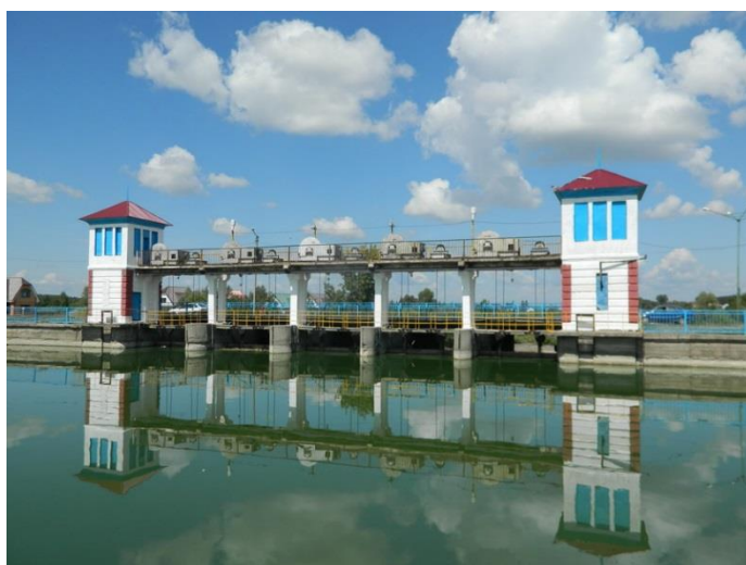
Фото 11 Водосбросное устройство на плотине
